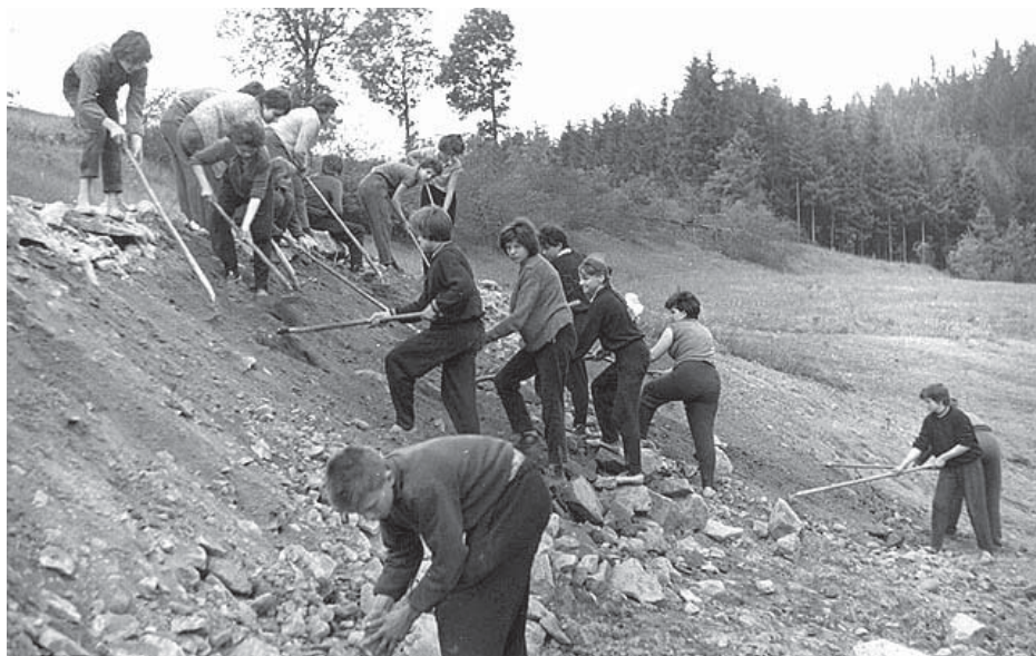
Z brigádnických prací učitelů a žáků na stavbě koupaliště – stavba profilu hráze
